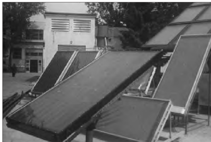
Captatoare solare realizate la ICSITEE
