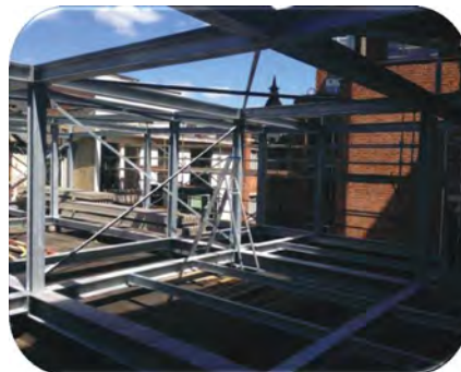
Centrala termică - faza 2
