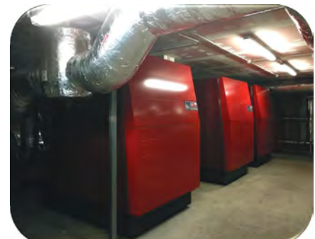
Centrala termică - faza 3
